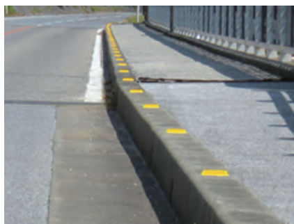
縁石（樹脂製・貼付式）
